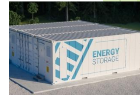
Verkon stabilointi akkuvarastot
