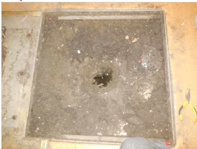
Keittiön lattiakaivo on hyvin likainen (tukkeutumisen vaara).
