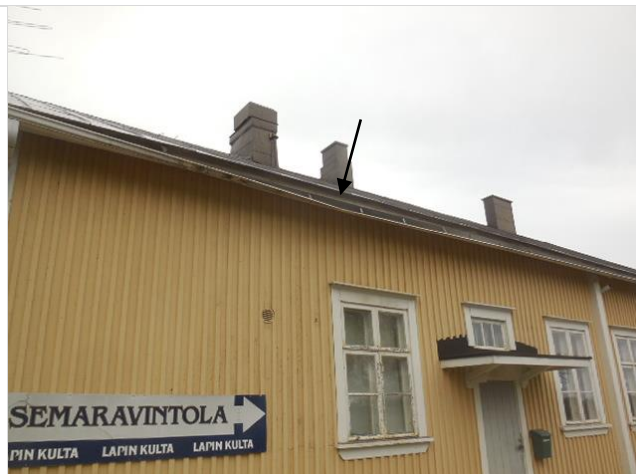
Vesikouru roikkuu ja valuttaa vettä rakennuksen vierelle.
