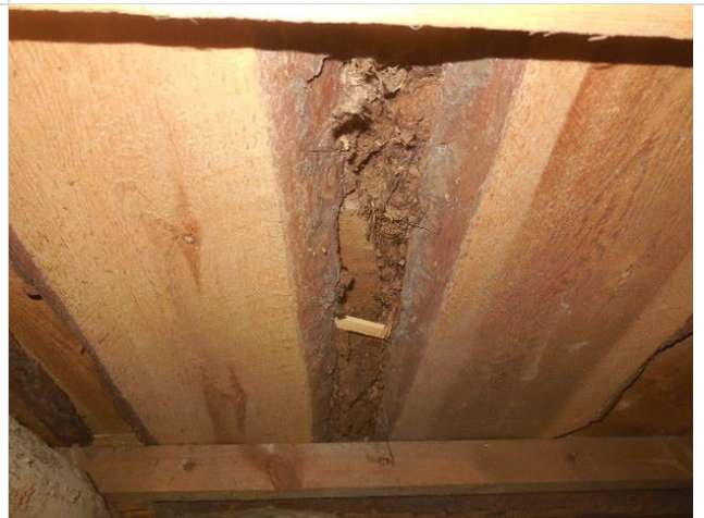
Alapohjarakenteen eristeessä havaittiin turvetta alkuperäisellä osalla (ravintolan puoli).
