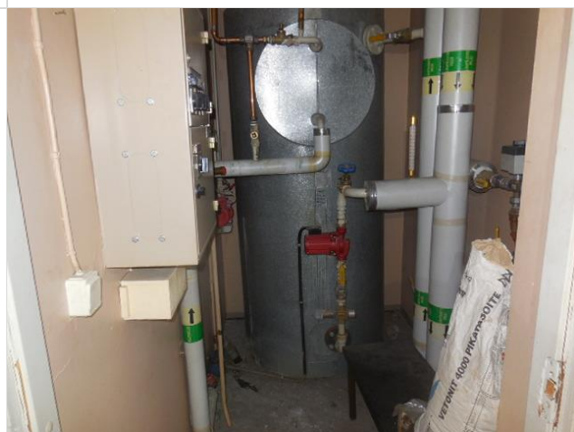
Yleiskuva sosiaaliilojen vieressä olevasta lämmönjakohuoneesta.
