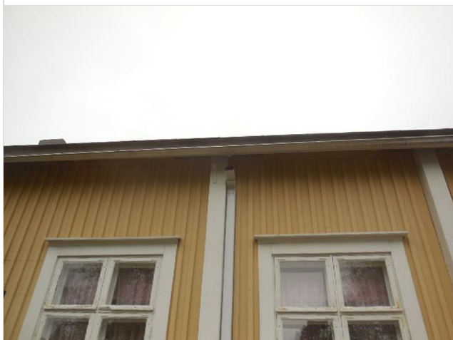
Syöksytorni ei ole paikoillaan sadevesikourussa.
