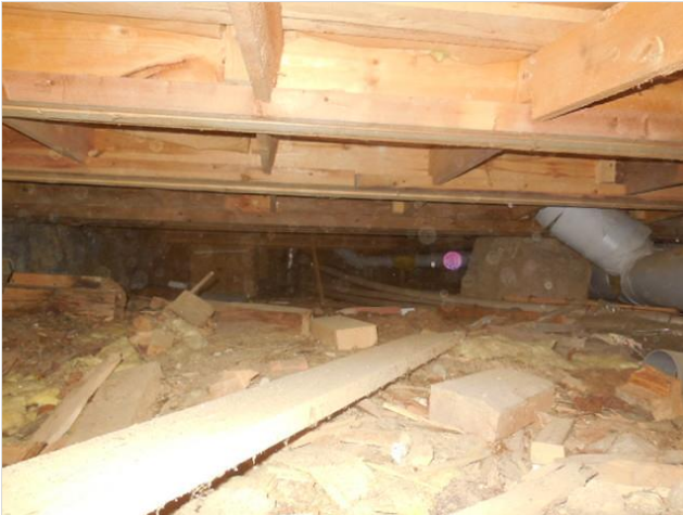
Yleiskuvaa peruskorjatulta puolelta (keittiö/sos. tilan puoli). Alapohjassa on runsaasti orgaanista jätettä.
