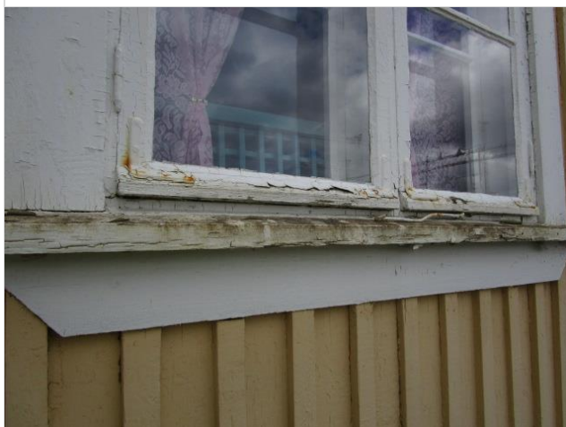
Rakennuksen ikkunoiden alaosan puurakenteet ovat lahot.
