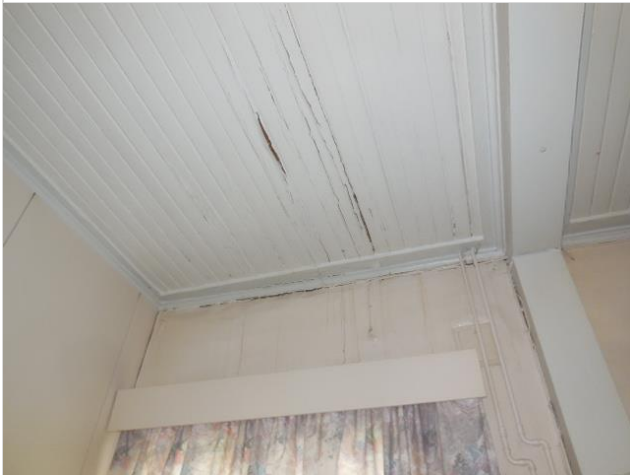
Kattopaneloinnissa havaittiin viitteitä vuodoista.
