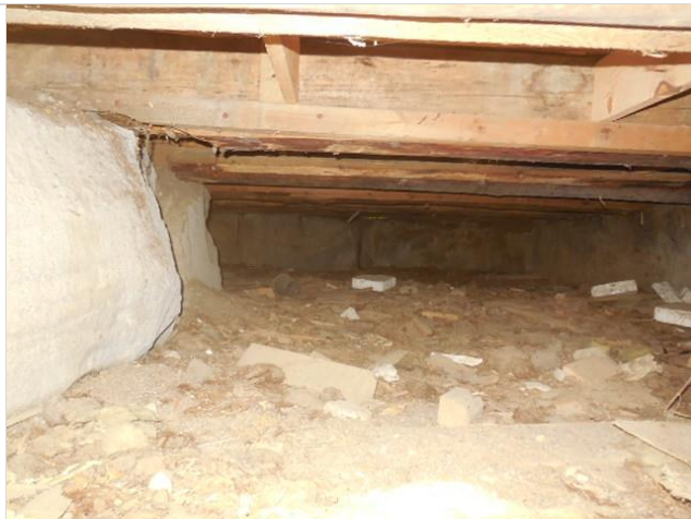
Rakennuksen alapohjan tuuletustilan nurkat jäävät ns. tuuletuskatveeseen.
