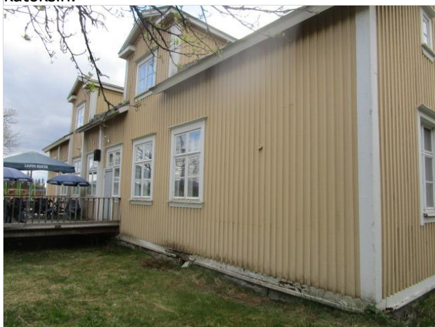
Rakennuksen kattovedet johdetaan rakennuksen vierelle. Roiskevedet lahottavat julkisivua.
