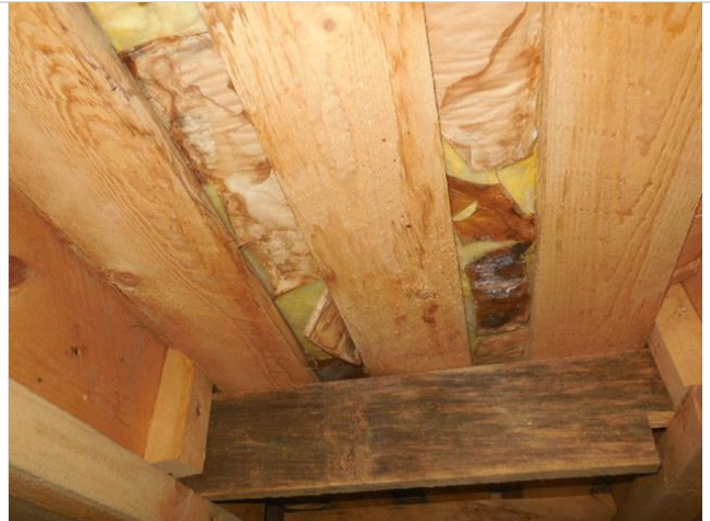
Rakennuksen alapohjan aluslaudoituksessa havaittiin uudella puolen keittiötilan kohdalla viitteitä mahdollisesta vuodosta.
