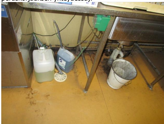
Keittiön pesualtaan alla havaittiin kohonneita pintakosteuspitoisuuksia.
