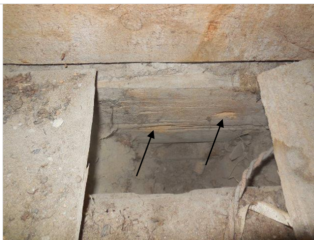
Yläpohjan eristekerroksen kohdalla ulkoseinän hirren pinnalla havaittiin lahoa (viittaa ilmansulkupaperin epätiiveyteen/lämpövuotoihin).
