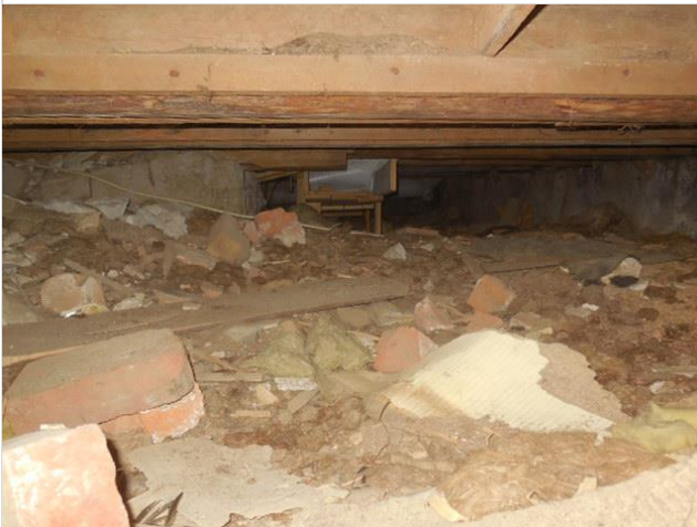
Yleiskuvaa rakennuksen alapohjan tuuletustilasta. Alapohjassa on runsaasti orgaanista jätettä.
