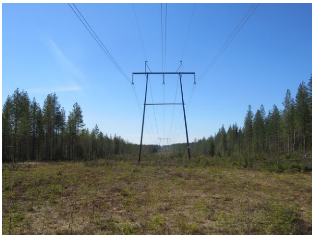
Kuva 19. Hankealueen halki kulkeva voimalinja Lehmimäen pohjoispuolella.
