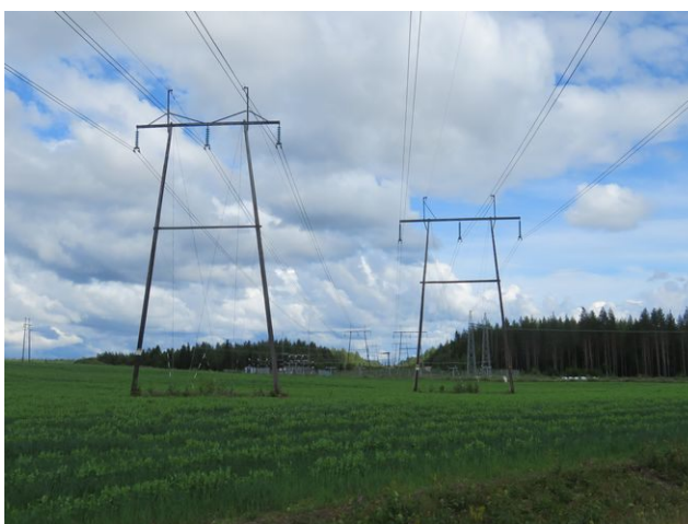
Kuva 32. Linja Uvan sähköaseman (taustalla) kohdalla.
